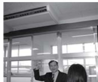
▲上頓野小学校図書館に整備 された冷暖房エアコン
